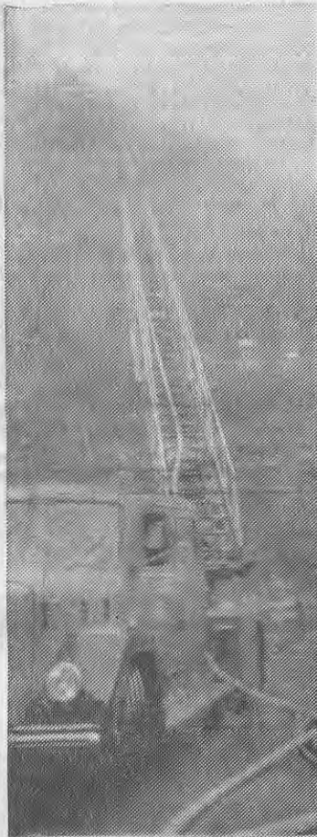
Über eine Drehleiter drangen die Feuerwehrleute in das brennende zweite Fabrikgeschoß ein.
