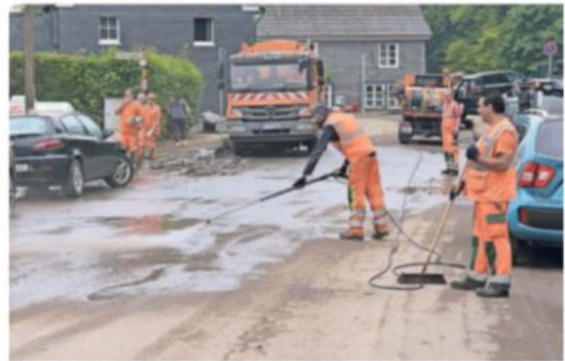
Die Mitarbeiter des ESW verhinderten, dass dicke Schlammschichten auf den Straßen festgetrocknet sind.
