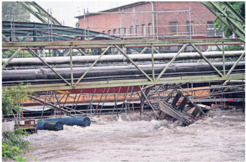
Feuerwehreinsatz: Die Wupper drohte, an der Kabelstraße ein Baugerüst einzureißen.
